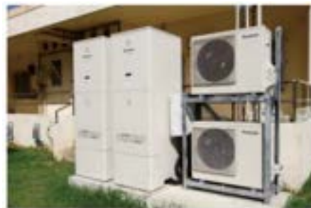
千葉県江ノ島町の住宅でエミールが設置されたヒートポンプ式給湯機と暖房機の室外機
