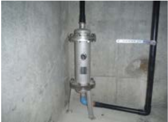
地下受水槽手前に設置してあるエミール
